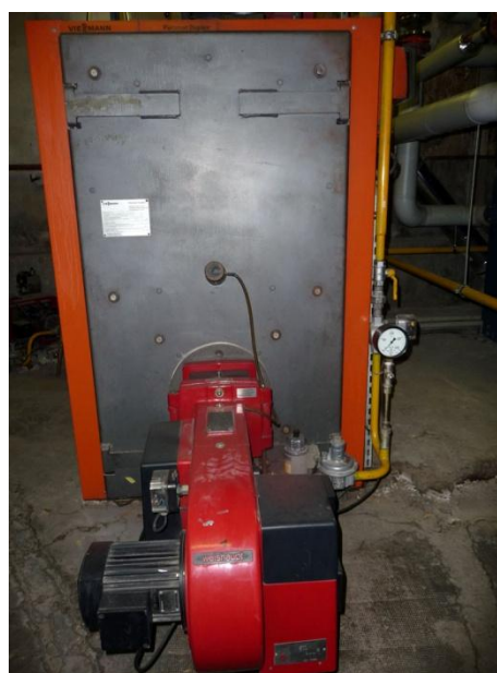
Chaudière VISSMANN avec brûleur WEISHAUPT de 330kW
