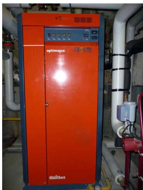
Chaudière à rampe GUILLOT OPTIMAGAZ de 230kW
